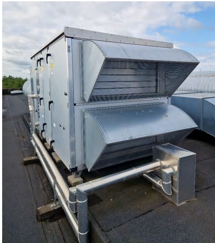
Figur 125: Ventilationsaggregat samt indtag og afkast til Hal 2 på taget af Hal 2.
