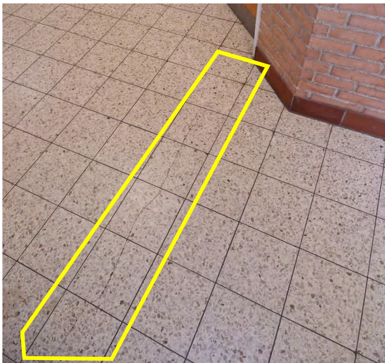
Figur 99: Revner i gulvet i cafeteria og toiletter ved Hal 2.
