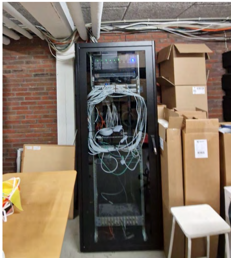
Figur 138: Rackskab med IT-installationer til gamerrum, kontorer etc.
