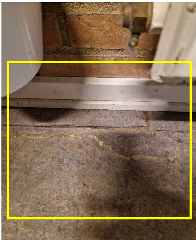
Figur 95: skader på linoleumsgulve relateret til fugt i depot ved Hal 2.
