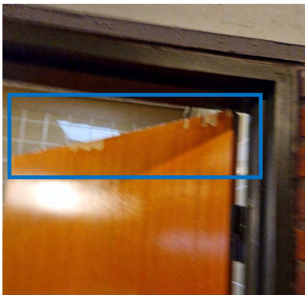
Figur 34: Beskadiget dør i omklædning.
