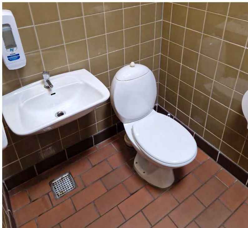
Figur 108: Toilet og armaturer i Klub- og omklædningsbygning.
