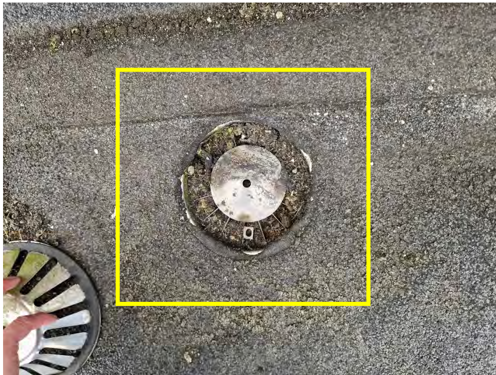
Figur 66: Tilstoppet afløb på taget af Hal 2.
