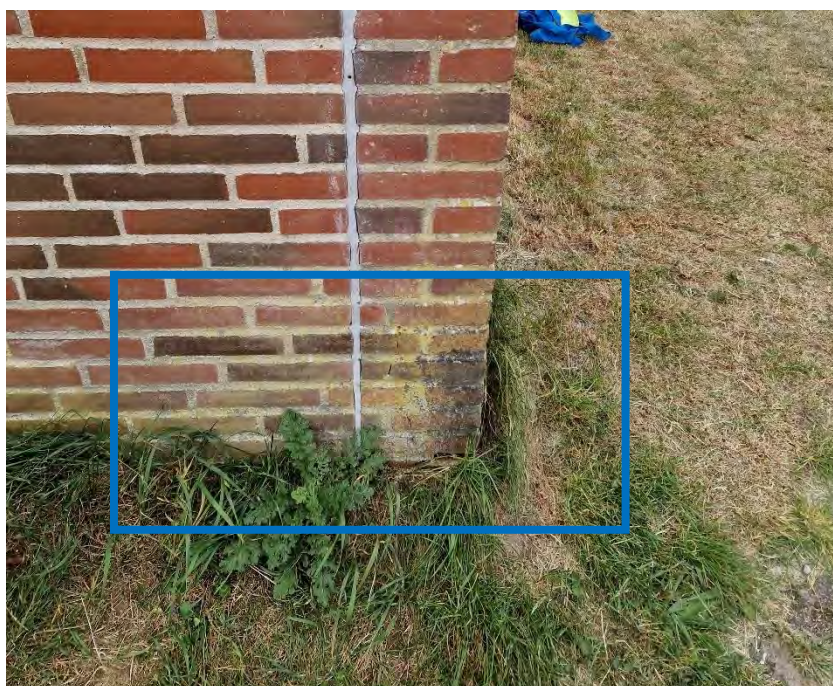
Figur 17: Opfugtet sokkel med begroning på hjørne sokkel ved Hal 3.
