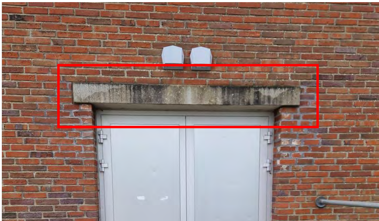
Figur 21: Misfarvet overligger på udsat gavl på Hal 1.
