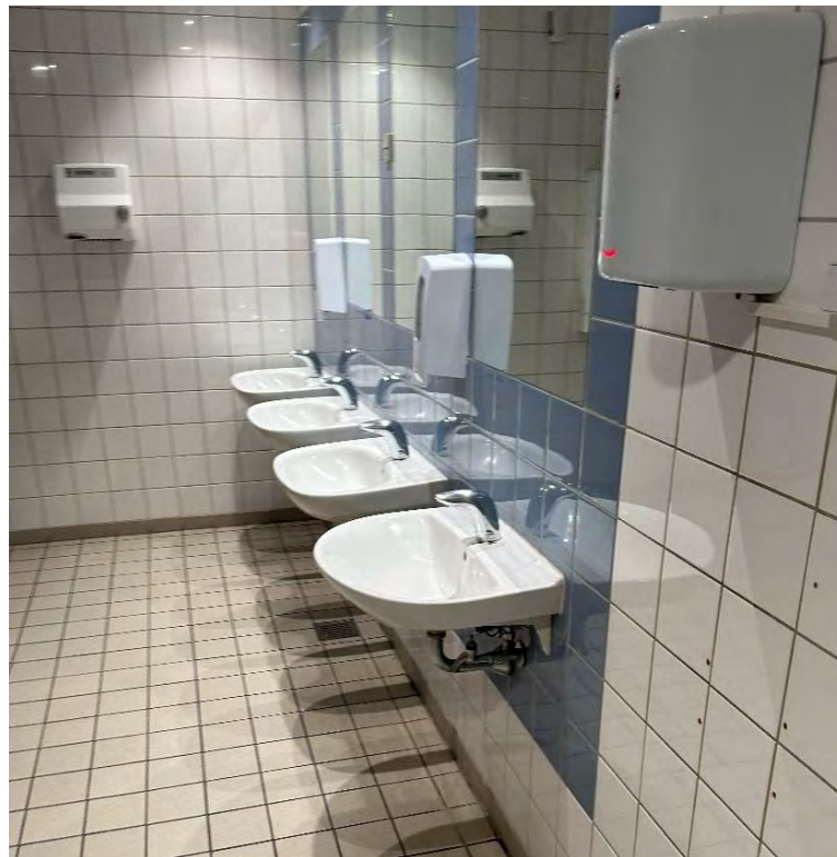
Figur 107: Nyere berøringsfri i ved Hal 2 og cafeteria.
