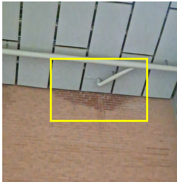
Figur 65: Fugt ophobning ved nedløbsrør i øst siden af Hal 2.
