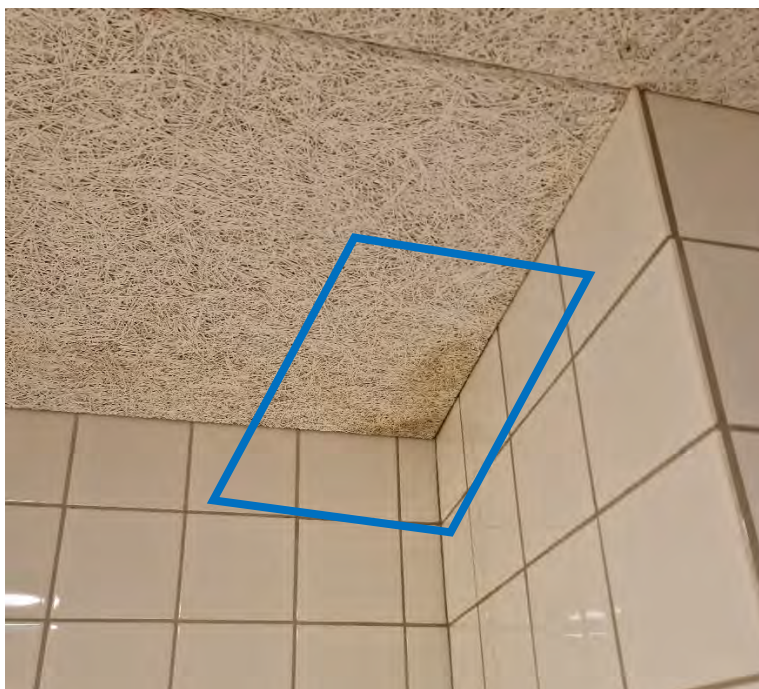
Figur 84: Træbeton med vandskade i toilet og bad mellem Hal 1 og Hal 3.
