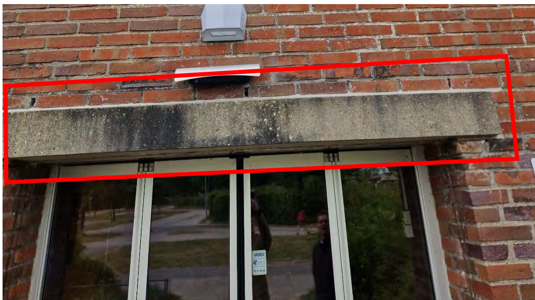
Figur 22: Misfarvet overligger på udsat gavl mellem Hal 1 og Hal 3.
