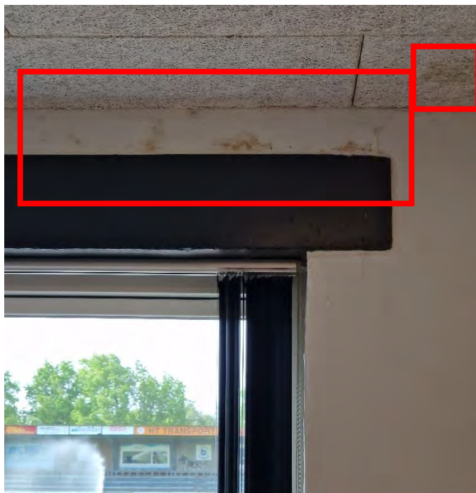
Figur 92: Skader på ydervægge over overligger og på loft i kontor.
