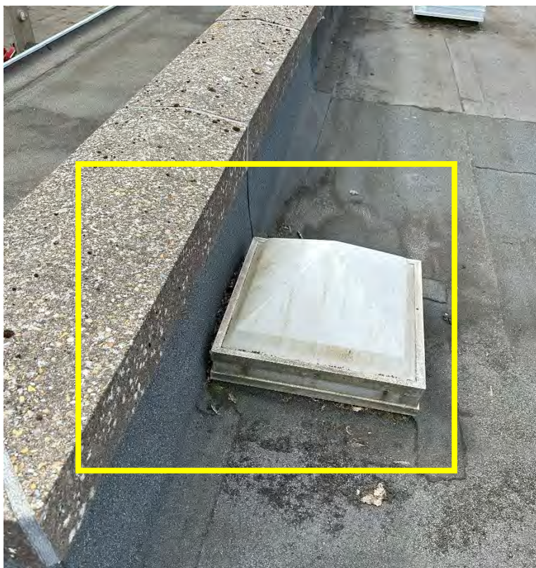
Figur 47: Ovenlys i Klub- og omklædningsbygning ligger tæt på tagfladen og murkronen.
