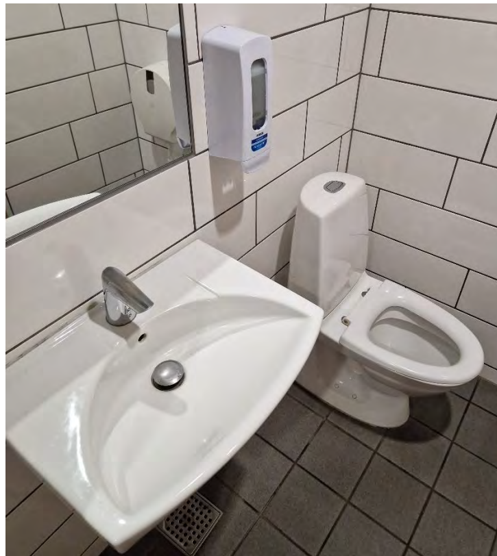
Figur 105: Toilet og armaturer mellem Hal 1 og Hal 3.
