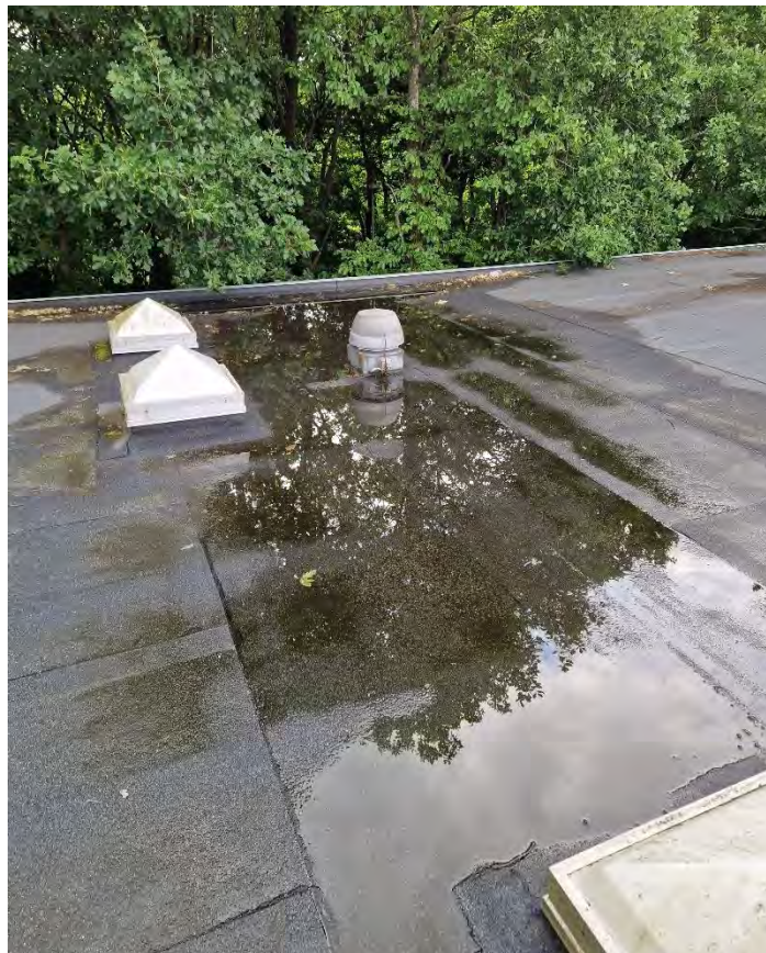
Figur 57: Lunke på tag af Klub- og omklædningsbygning hvor der står vand.
