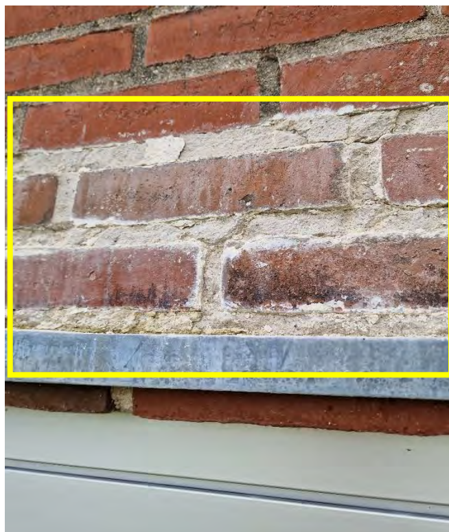
Figur 13: Omfugning som revner og falder ud ved dør ved Hal 3.
