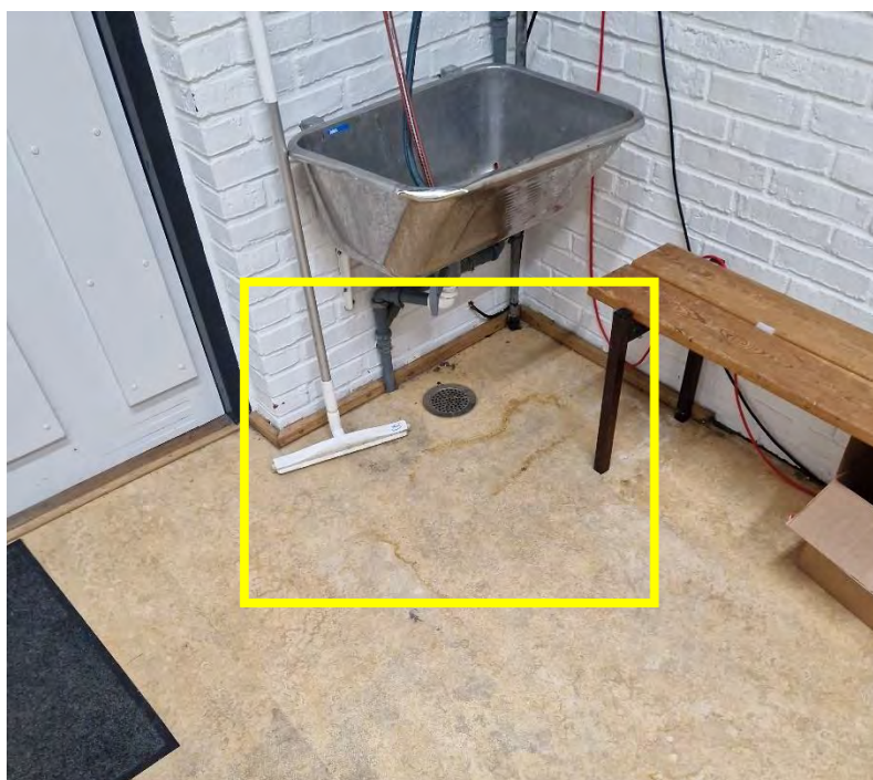
Figur 96: Skader på linoleumsgulve relateret til fugt i aktivitetsrum ved Hal 1.
