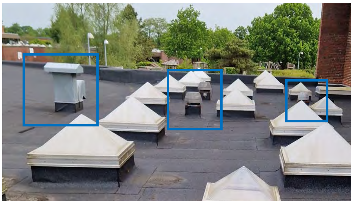
Figur 130: Til venstre ses indtag og afkast til Hal 3 til højre er udsugning fra omklædning og drengetoilet.
