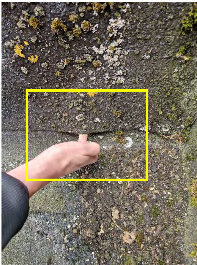
Figur 68: Tagpapdækning som har sluppet i samlingen i sydøstligt hjørne af Hal 2.
