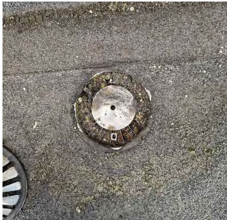
Figur 118: Tilstoppet afløb på taget af Hal 2.
