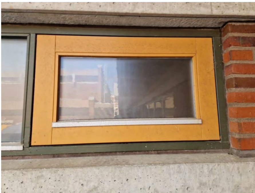
Figur 42: Vindue under udhæng i omklædningsbygning.
