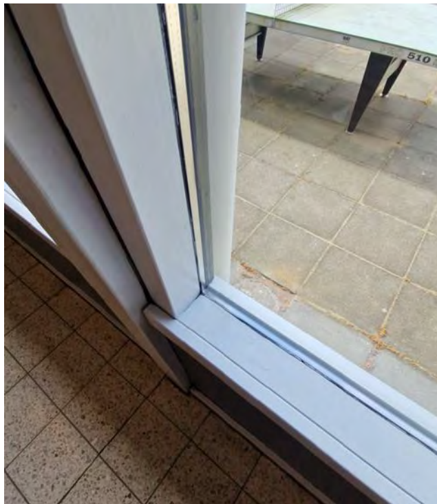
Figur 44: Ældre vinduer i gangarealet Klub- og omklædningsbygning.
