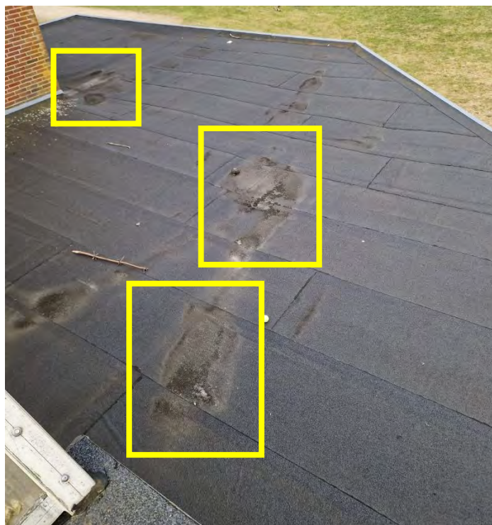
Figur 77: Lunker på taget ved indgangsparti mellem Hal 2 og Hal 3.
