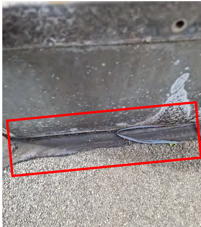
Figur 59: Fuge ved taghætte på Klub og omklædningsbygning.
