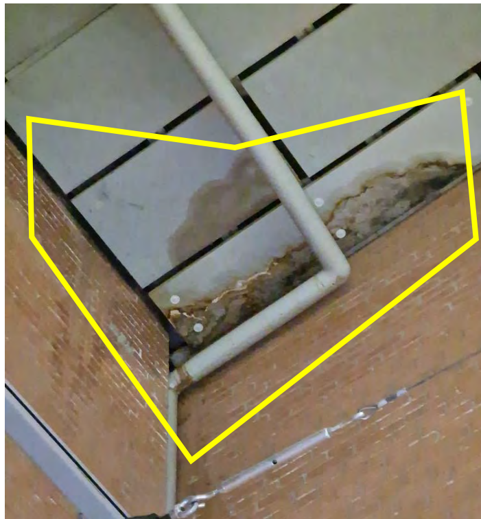
Figur 64: Fugt skader i sydøstligt hjørne af Hal 2.
