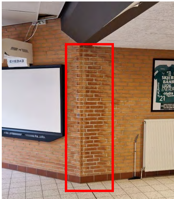
Figur 73: Fugt i murværk i samlingen mellem Hal 1 og Hal 2.
