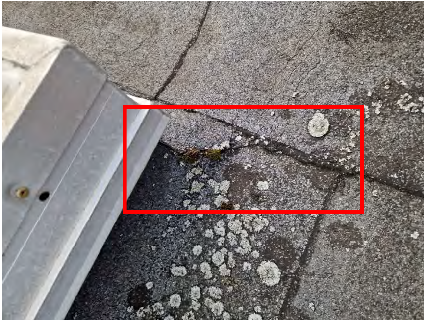
Figur 61: Fuge ved ovenlys på Klub og omklædningsbygning.
