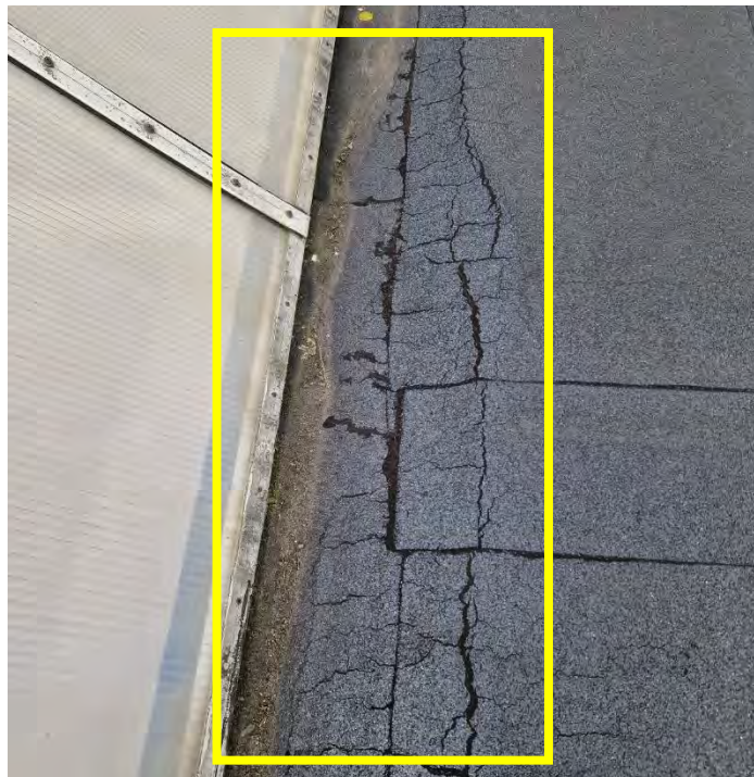
Figur 76: Tagpapdækning krakelerer i samlingen i Hal 1 og cafeteria.
