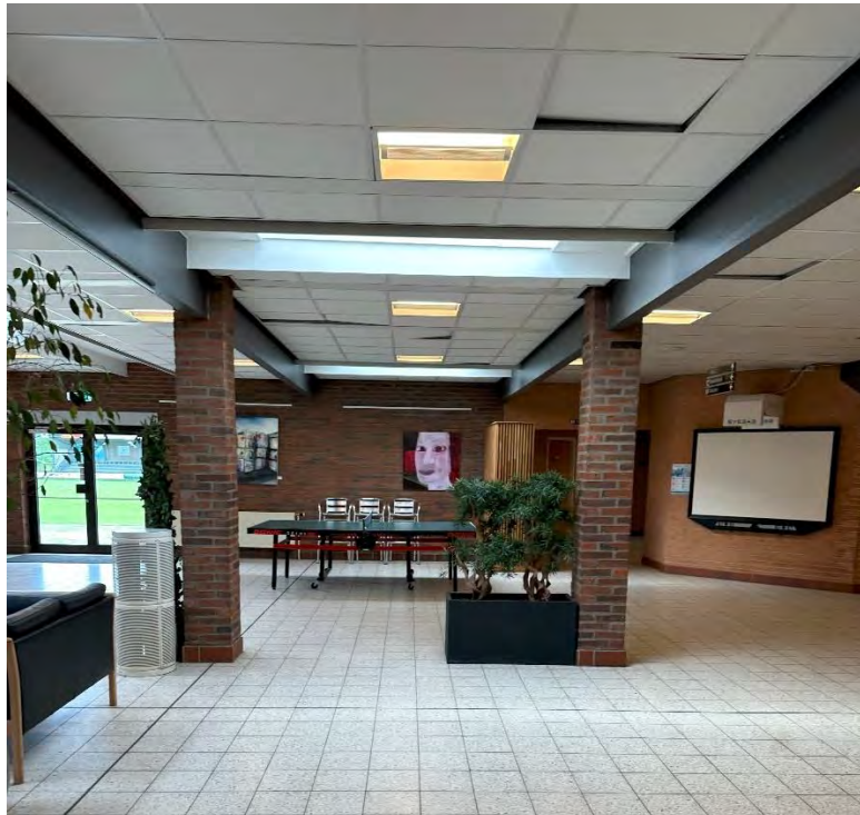
Figur 86: Nedhængte akustiklofter i cafeteriaområde.
