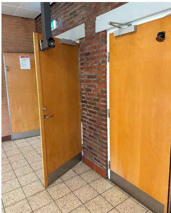
Figur 32: Dobbeldøre fra cafeteria til Hal 2 med dørpumpe.
