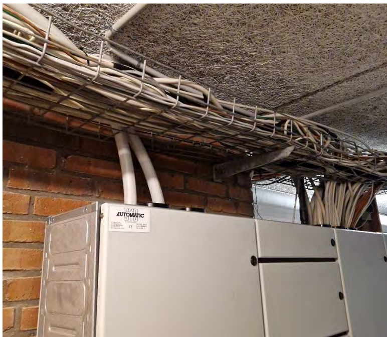
Figur 135: Kabelbakke ved eltavle i teknikrummet.
