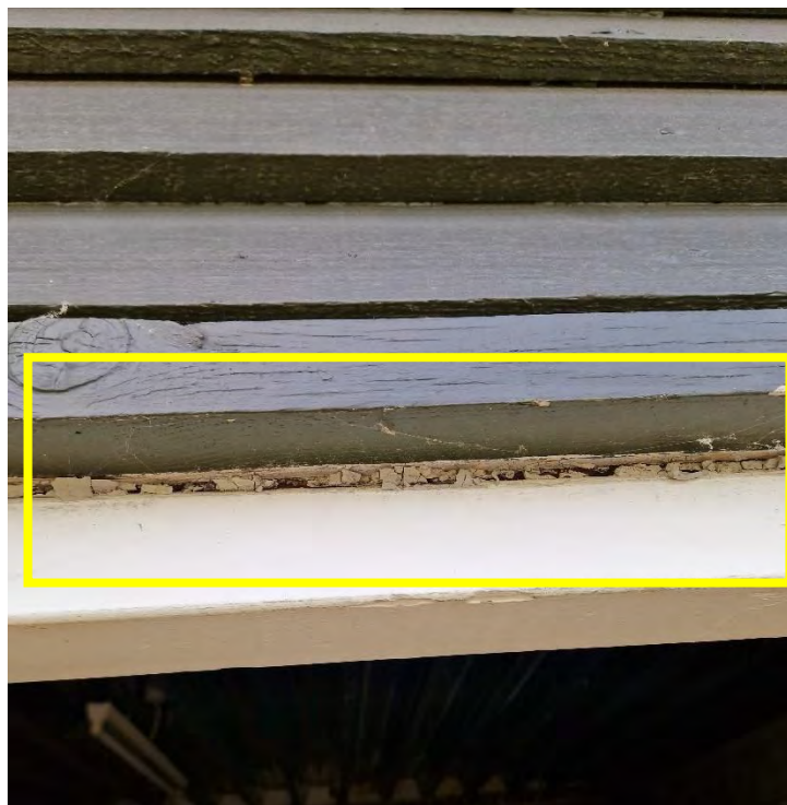
Figur 28: Beskadiget fuge ved udendørs depot.
