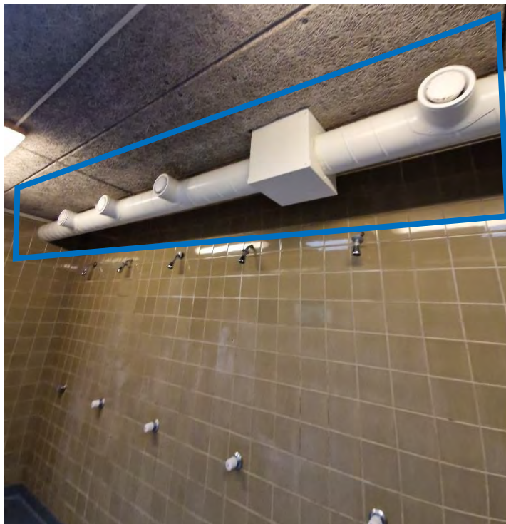
Figur 127: Udsugningsarmatur i bad i Klub- og omklædningsbygning.
