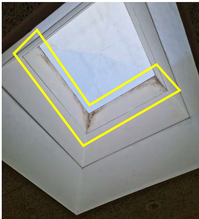
Figur 50: Fugt i ovenlys i omklædningsrum mellem Hal 1 og Hal 3.
