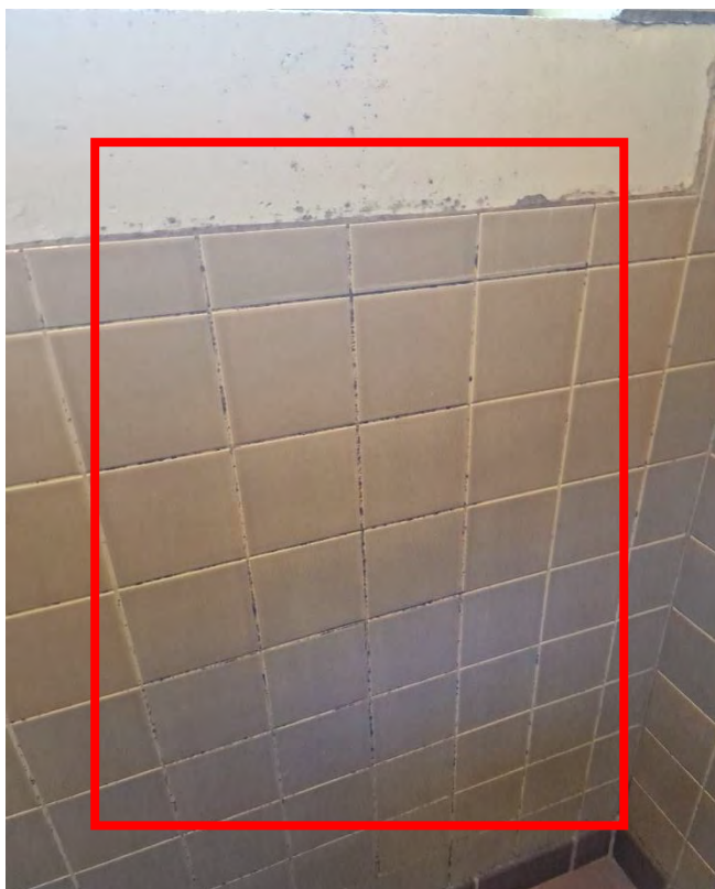
Figur 91: Svamp i fuger i omklædningsrum.
