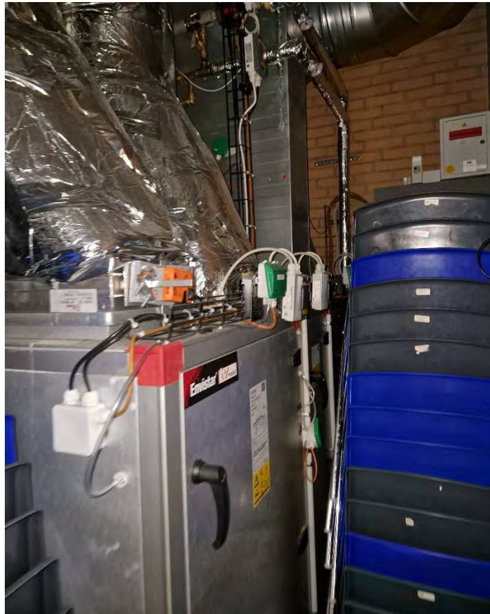
Figur 123: Ventilationsaggregat til Hal 3 fra 2023 i depot.
