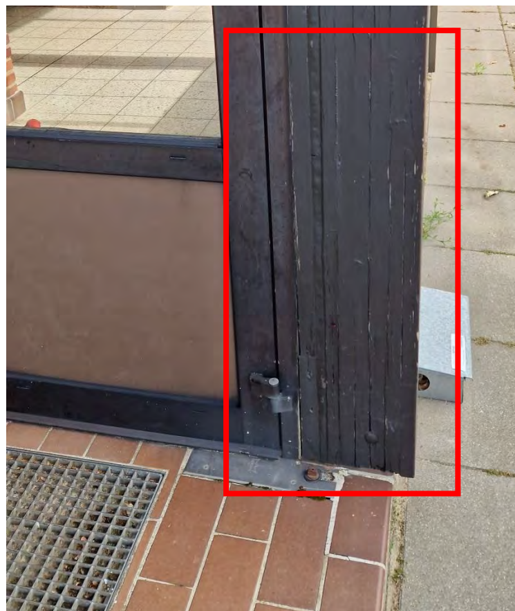
Figur 41: Gammel dør til omklædningsbygning viser tegn på fugtskader.
