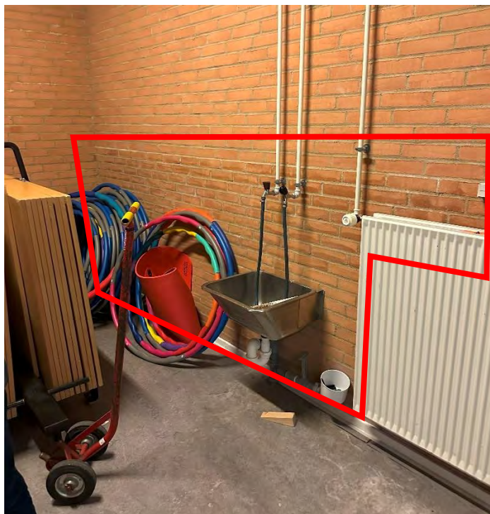
Figur 90: Fugt i teglmur mod jord i depot.
