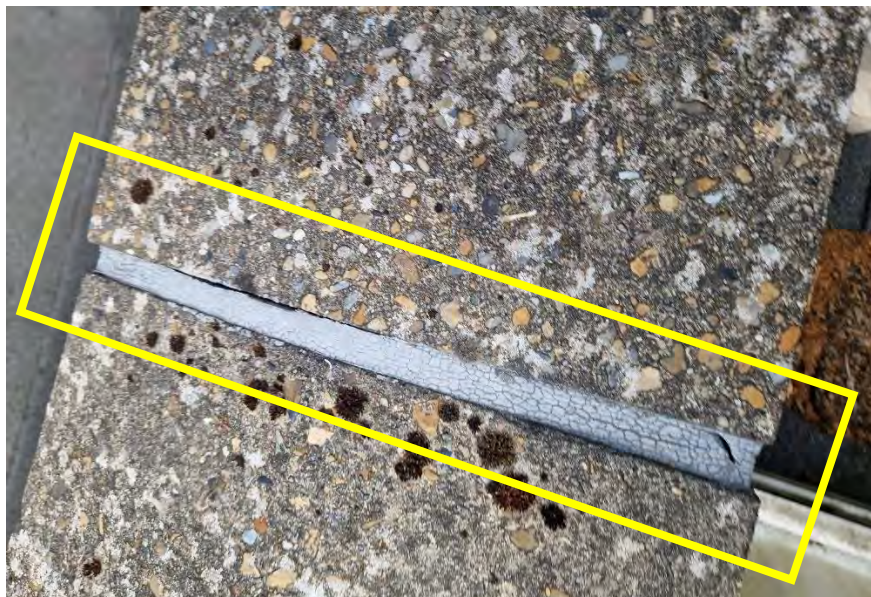
Figur 23: Gammel fuge i murkrone på taget af Klub- og omklædningsbygning.
