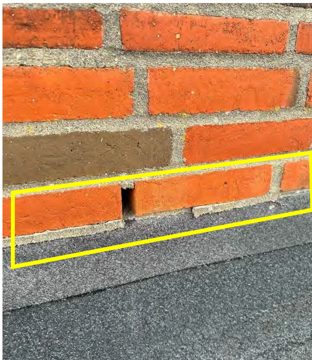
Figur 14: Fuge falder ud og manglende insektnet i studsuge
