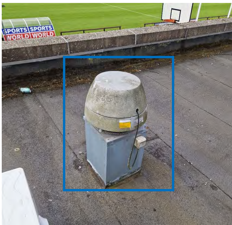
Figur 129: Udsugningsanlæg i gamerrum.
