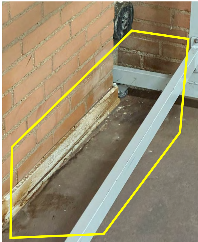
Figur 93: Skader på gulvet og fodlisten i det sydøstlige hjørne af Hal 2.
