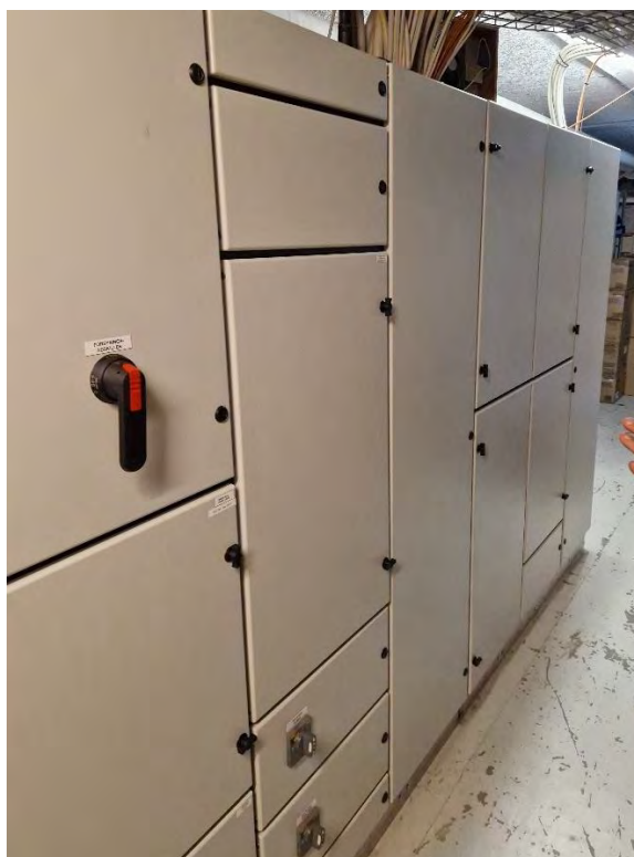
Figur 136: Ny eltavle fra 2024 i teknikrummet.
