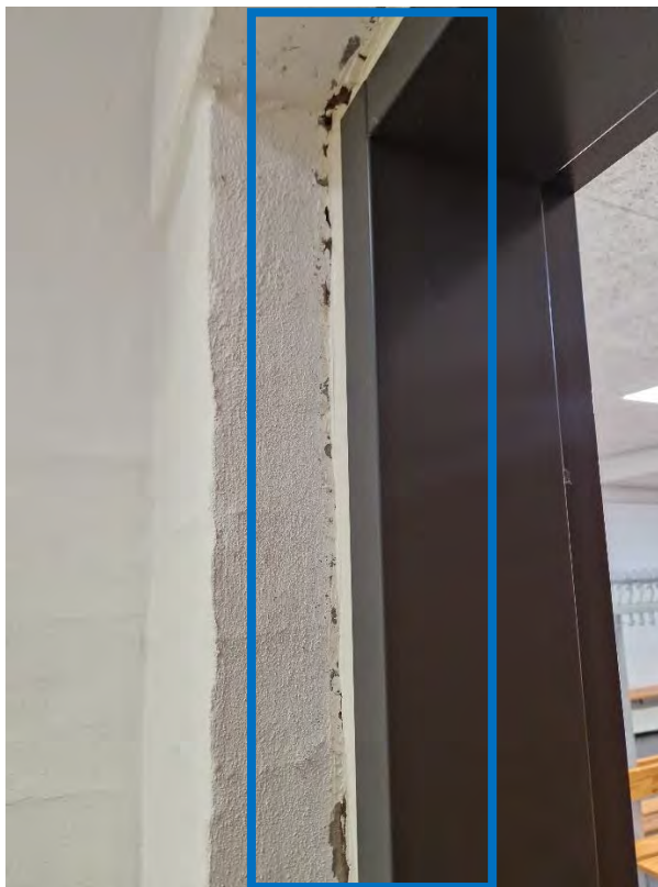
Figur 33: Fuger omkring døre i omklædningsrum.
