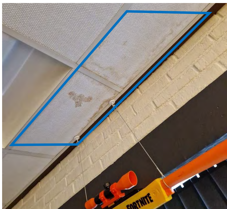
Figur 89: Vandskade på nedhængt akustikloft i gamerrum.
