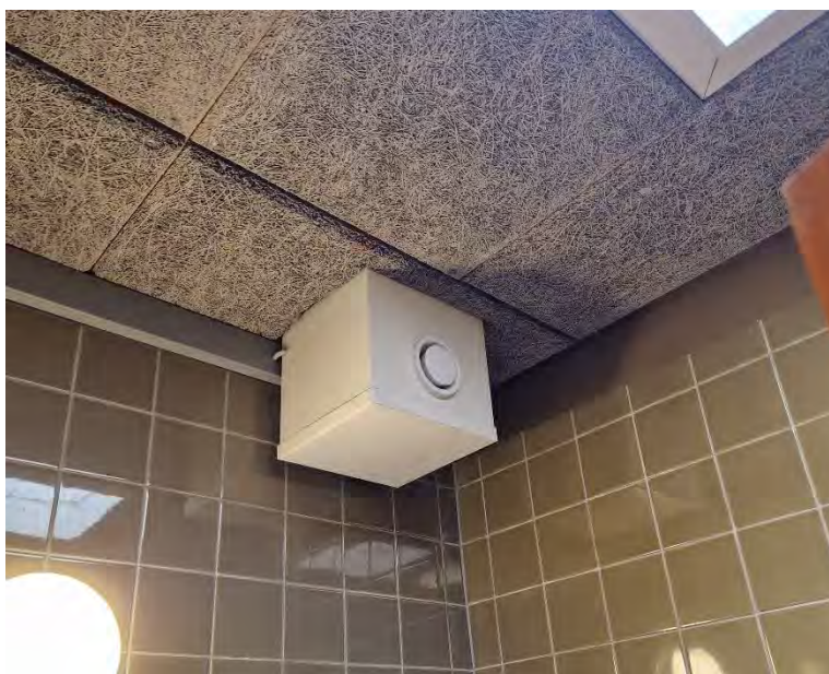
Figur 85: Træbeton og udsugning i Klub- og omklædningsbygning.
