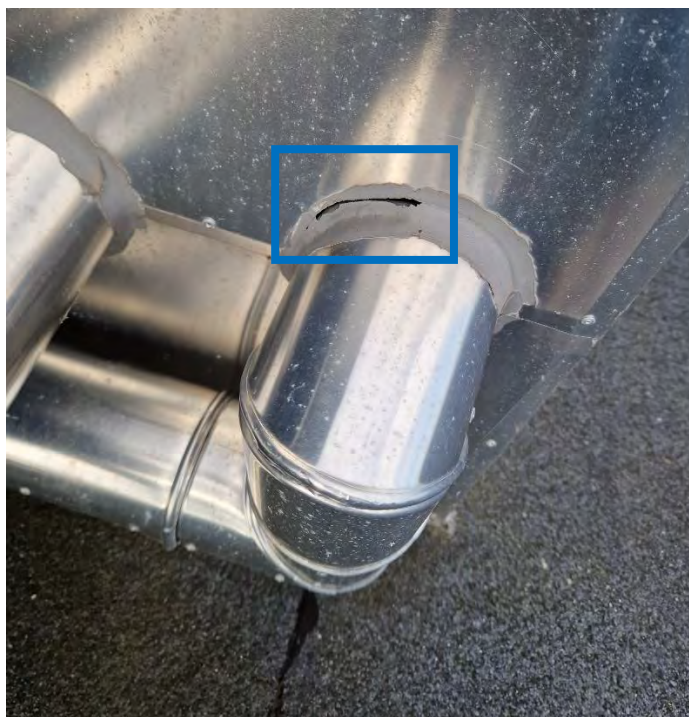
Figur 132: Beskadiget fuge på ventilationskanal til Hal 2.
