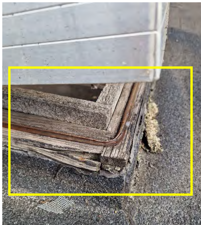
Figur 49: Ovenlys over Køkken depot ligger tæt på tagfladen og liste er ødelagt.
