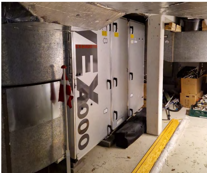
Figur 121: Ventilationsaggregat fra 2021 til Hal 1 i teknikum.
