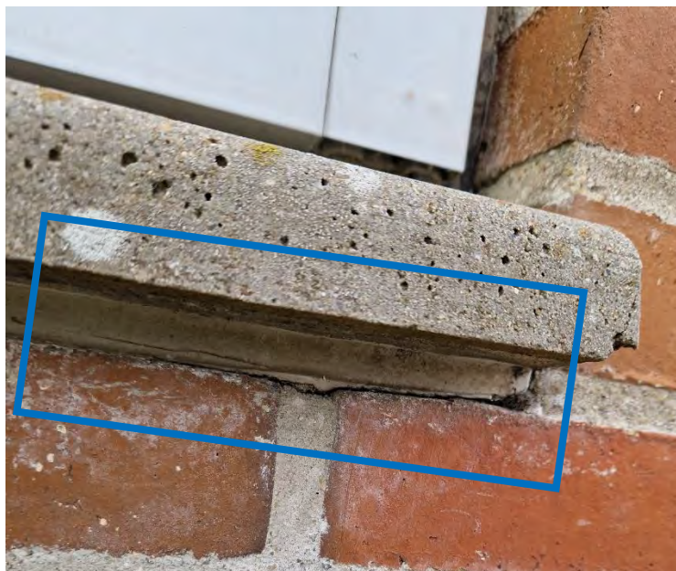
Figur 52: Fugeslip i vindue til springsalen.
