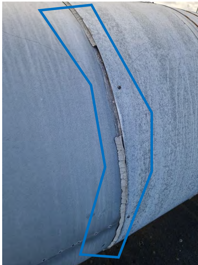
Figur 134: Fuge som er krakeleret på ventilationskanal til Hal 2.
