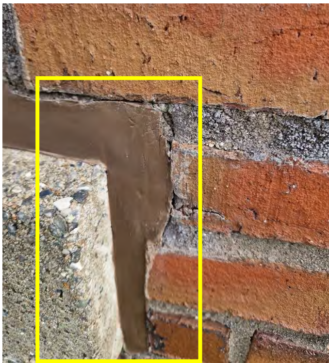
Figur 26: Repareret fuge over sålbænk som er begyndt at revne igen.
