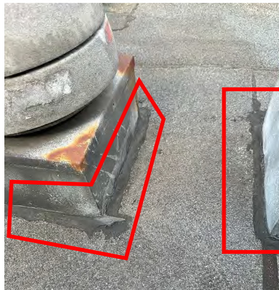
Figur 60: Fuger ved taghætte på Klub og omklædningsbygning.
